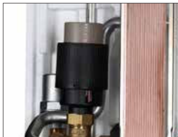
Reguleringsventil til brugsvandstemperatur.
