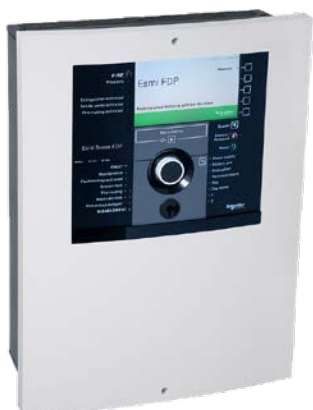
Esmi Sense FDP fire Alarm panels:
