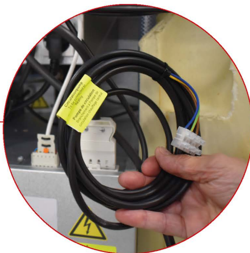
Forsyningsledning for cirkulationspumpe til centralkreds
