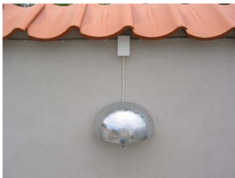
Belysning med kabel/ledning.
