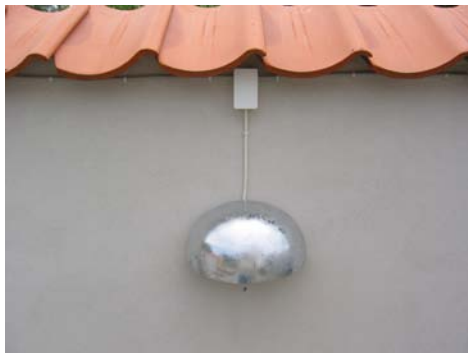
Belysning med kabel/ledning.
