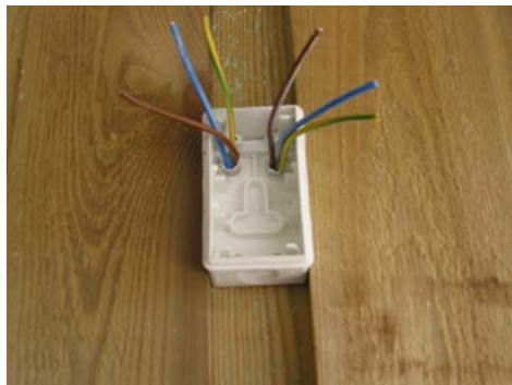
Skjult installation til og afgang.
