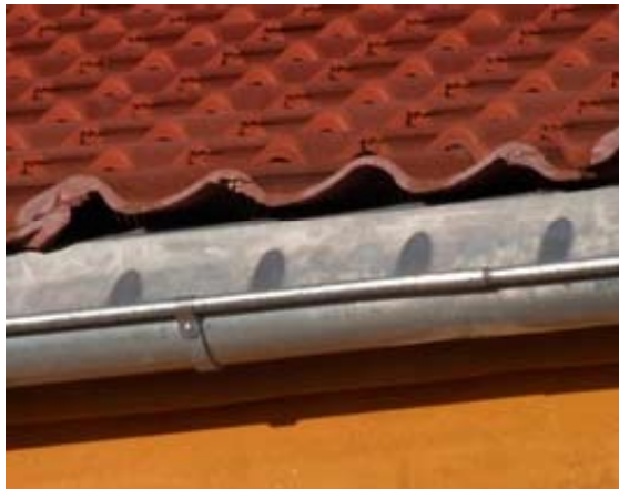
Billede: Dryp fra betontagsten
