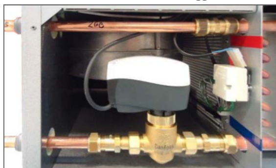
4. Frosttermostat (B3) monteret på vand- eftervarmeplade.
