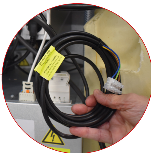
Forsyningsledning for cirkulationspumpe til centralkreds
